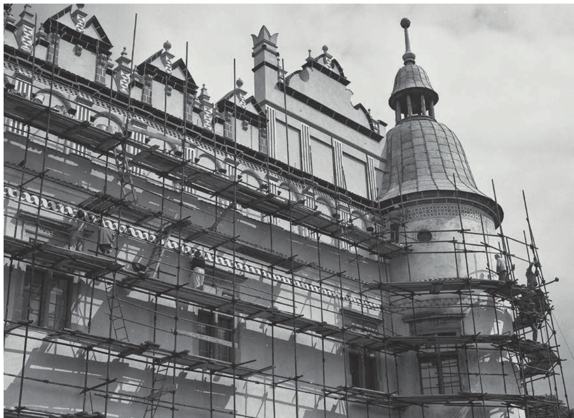
Prace konserwatorsko-remontowe przy jednej z elewacji zamku baranowskiego, 1980 r. Zbiory Sławomira Stępaka
